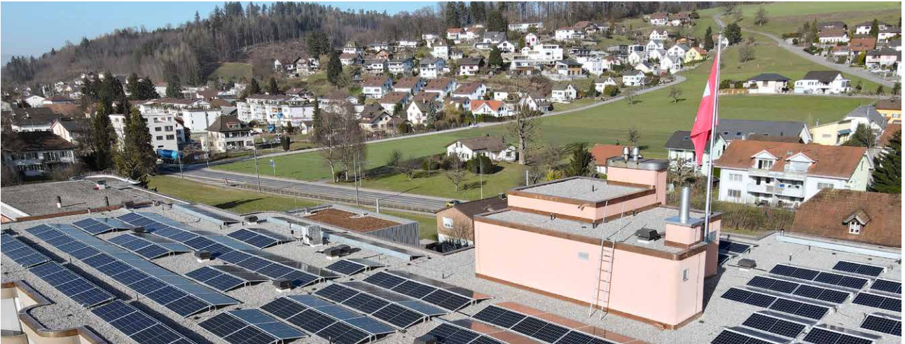
Photovoltaikanlage mit Sicht auf Unterkulm
